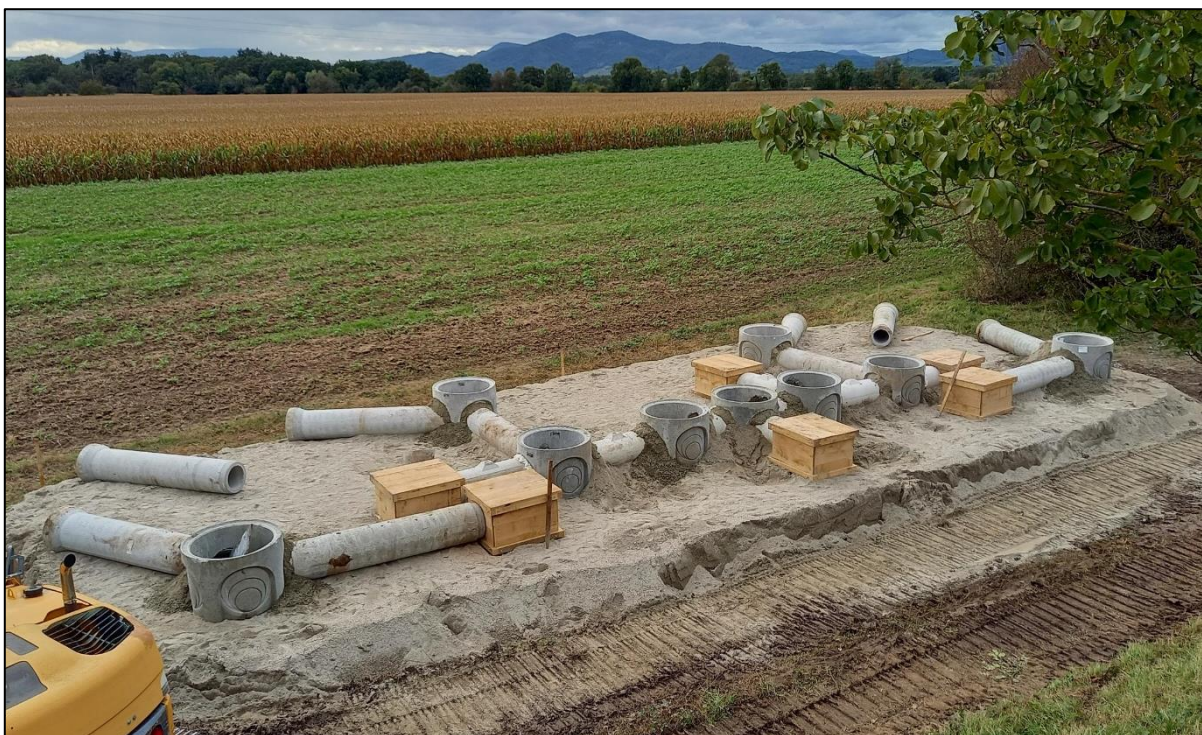
Figure 16 – Terrier artificiel à l'échangeur de Kogenheim © Pôle MFS LPO/GEPMA
